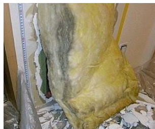
濡れた断熱材のカビ
