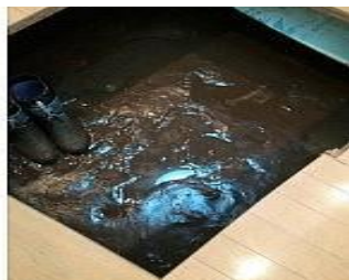
フローリング浸水の床下
